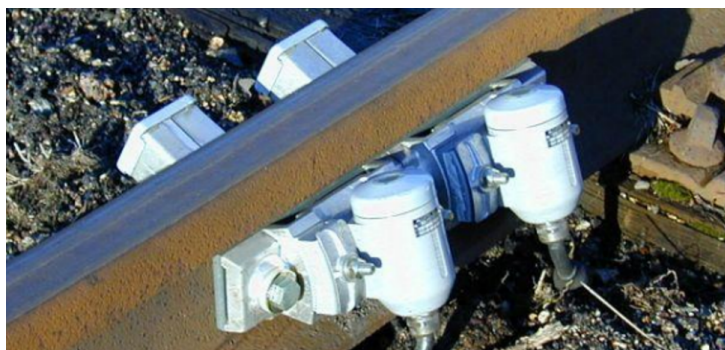
Obrázek 2.4: Instalace počítače náprav Alcatel 6221-A3 na kolejnici.
